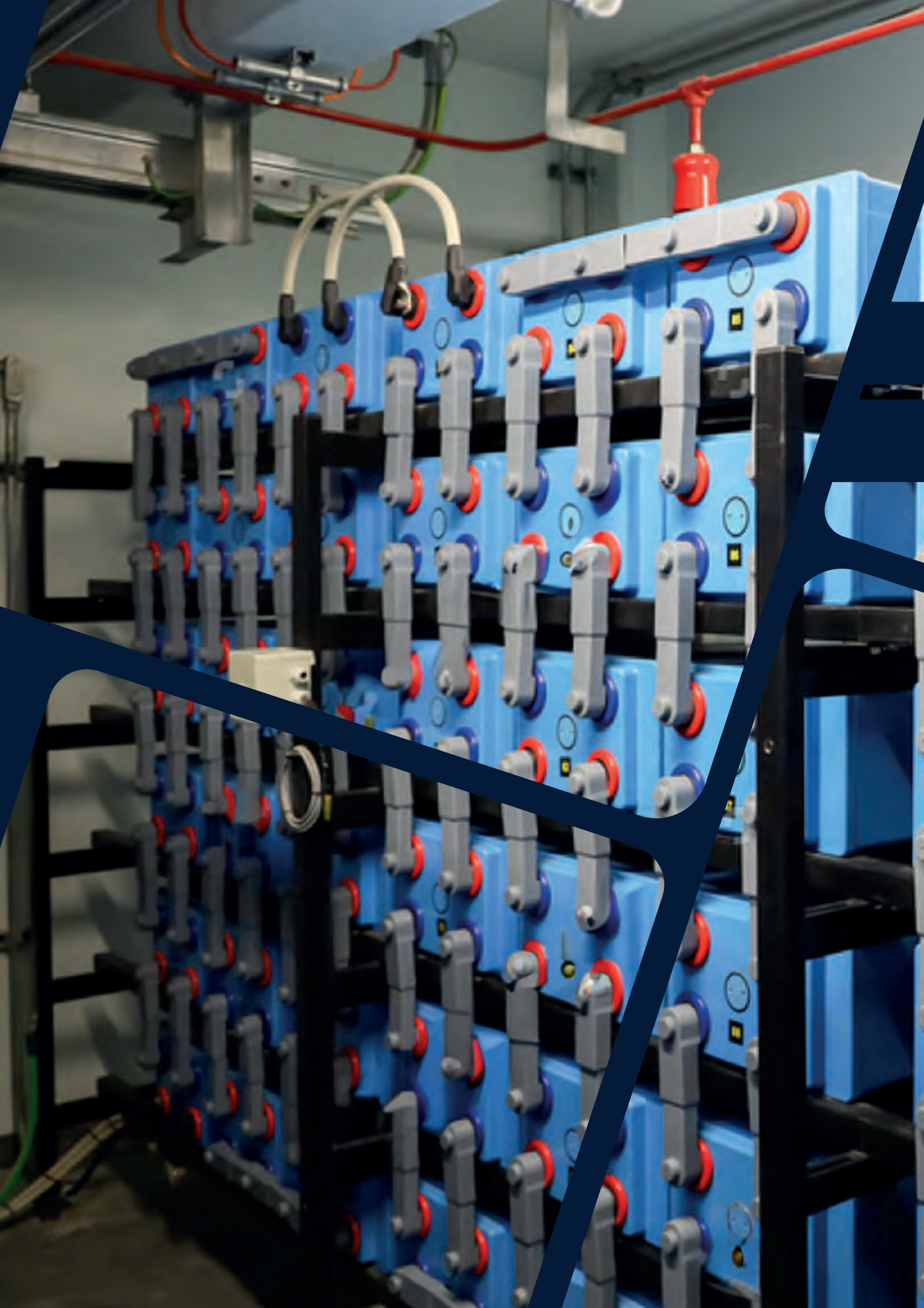
Ups & Akü Odaları
